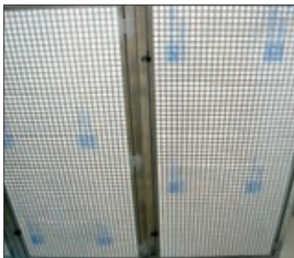
распределительный короб с фильтрами для приточного воздуха
